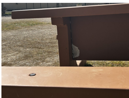
A peine installées dégradation des tables de Pique nique
